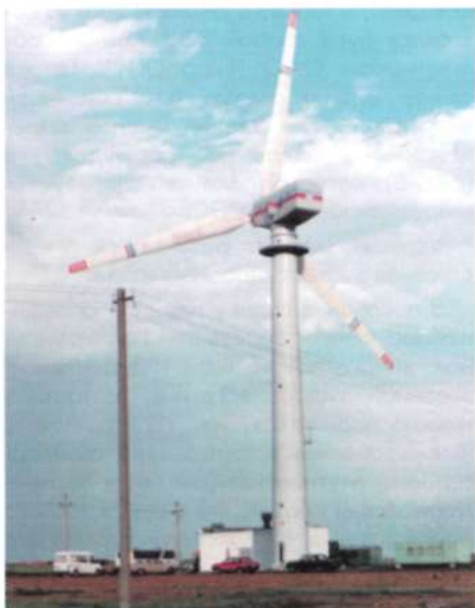
Рис. 4. Ветроустановка "Радуга" мощностью 1000 кВт
